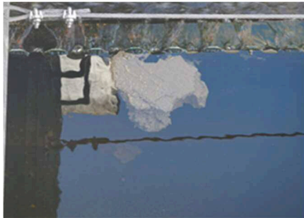
図5 最終沈殿池における汚泥の再浮上
