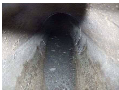
Pic4 土砂堆積（水位上昇跡）
