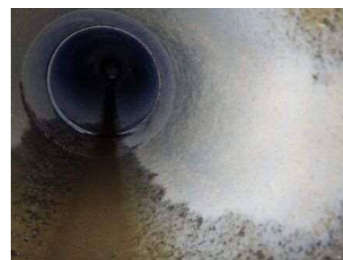
pic6 雨天時浸入水跡
