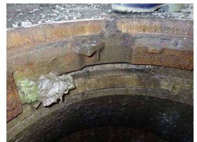
pic3 6号幹線末端調整部
