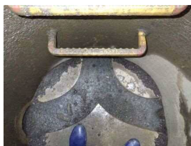
Pic5 土砂堆積
