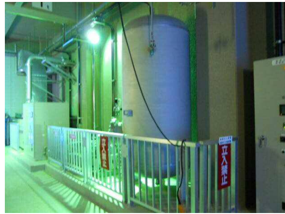
写真-2 川合中継ポンプ場酸素注入設備 (手前から酸素タンク・昇圧器・酸素発生機・空気圧縮機)
