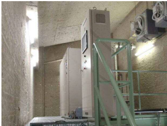
写真-1 松留中継ポンプ場酸素注入設備 (手前から現場動力制御盤・酸素発生機)
