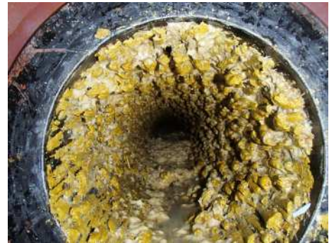
図1 汚泥棟地下配管内の付着物
