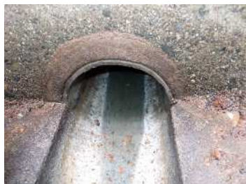
図1 栄一丁目マンホールポンプ吐出先マンホール
